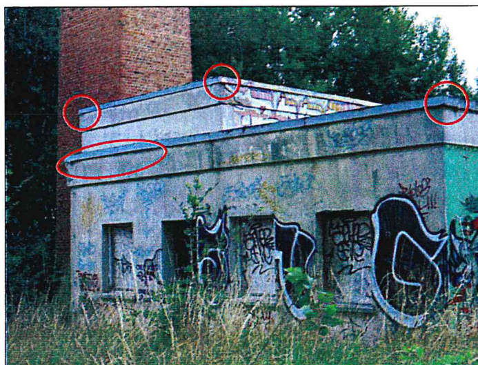
Abbildung 14: : Lage der Einzelquartiere Q2-2 bis Q2-5 am ehemaligen Heizhaus (unter Dachkantenblechen).
